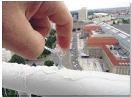
Vogelabwehrpaste an einem Wohn-Hochhaus in Leipzig. Foto: Karsten Peterlein
